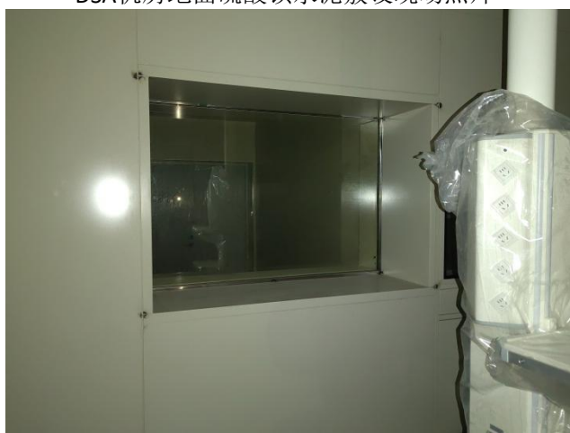
控制室铅防护窗
